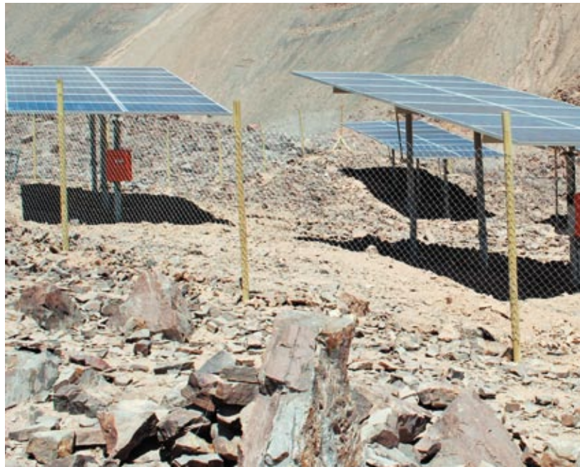
En una primera etapa el proyecto cuenta con seis paneles fotovoltaicos.
